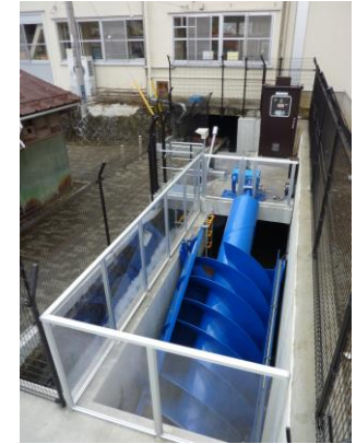
らせん水車発電機
